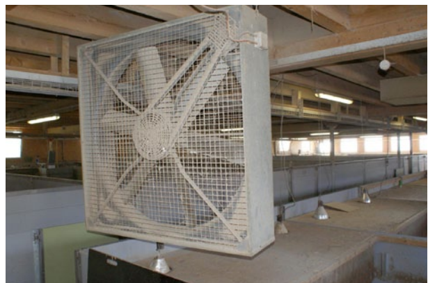
Ein Grossraumventilator bewegt die Luft im Stall.
